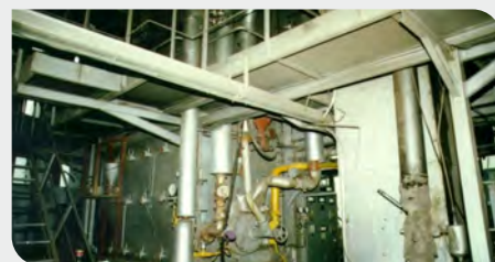
Vederea frontului cazanului pilot, cu poziționarea arzătorului de combustibil solid
