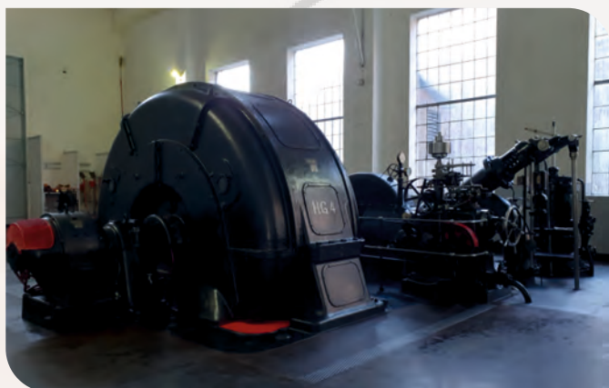
Hidroagregatul (turbina+generatorul) unei centrale hidroelectrice de mică putere echipată cu turbină pelton.
